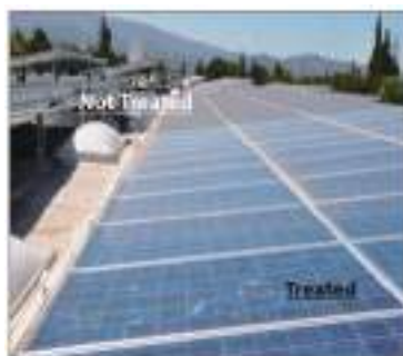
太陽光パネルの汚れの違い
