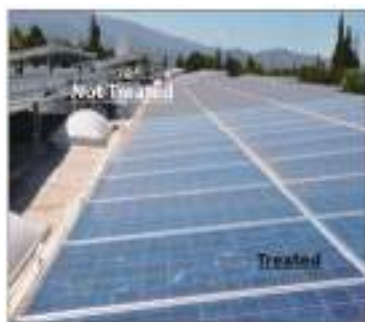
太陽光パネルの汚れの違い
