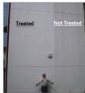
外壁の汚れの違い
